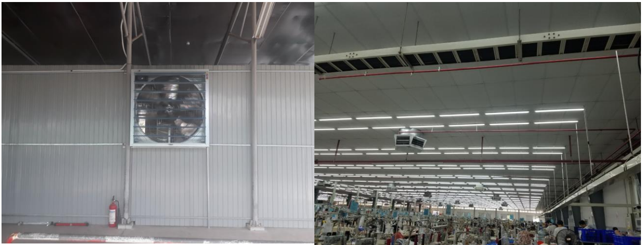
Hình 3.5. Hệ thống quạt thông gió, hệ thống làm mát
