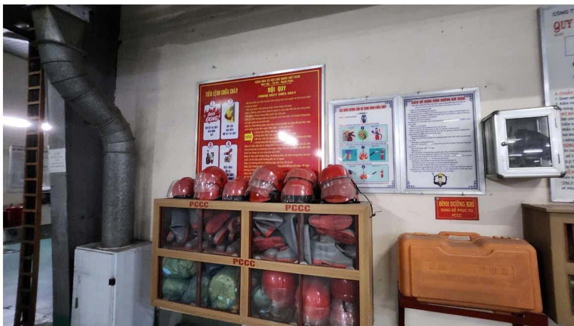
Hình 3.17. Hệ thống PCCC tại cơ sở
