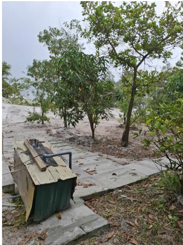
Hình 3.3. Hệ thống xử lý nước thải
