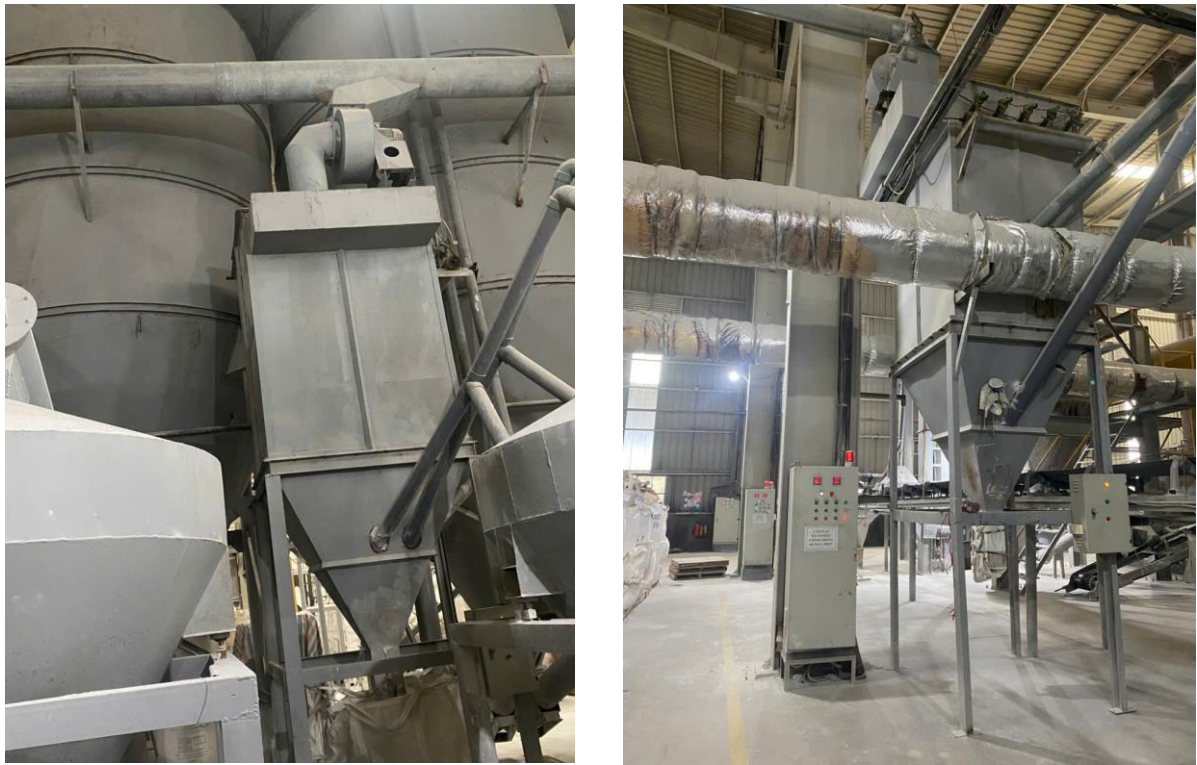
Hình 3.5. Các thiết bị xử lý bụi
