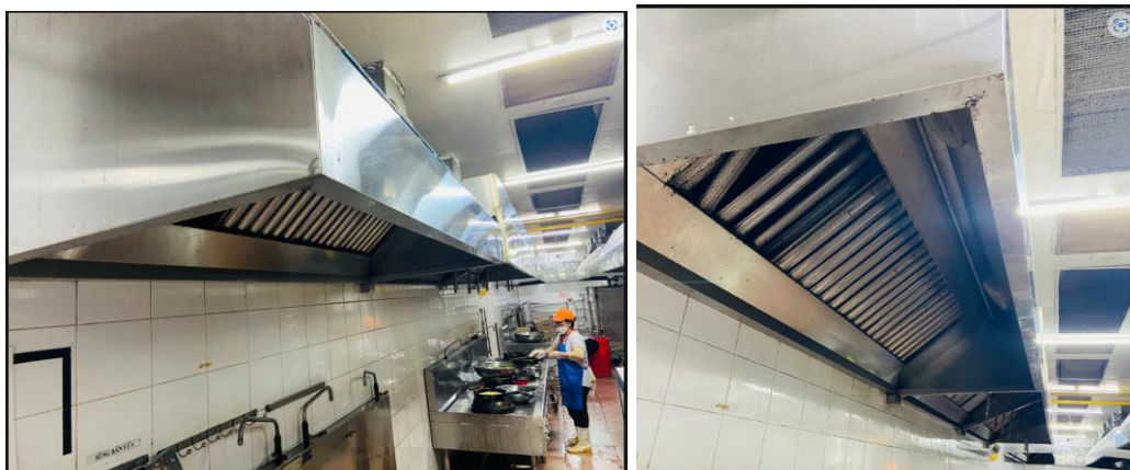
Hình 3.11. Hệ thống hút khói, khử mùi tại Nhà ăn
