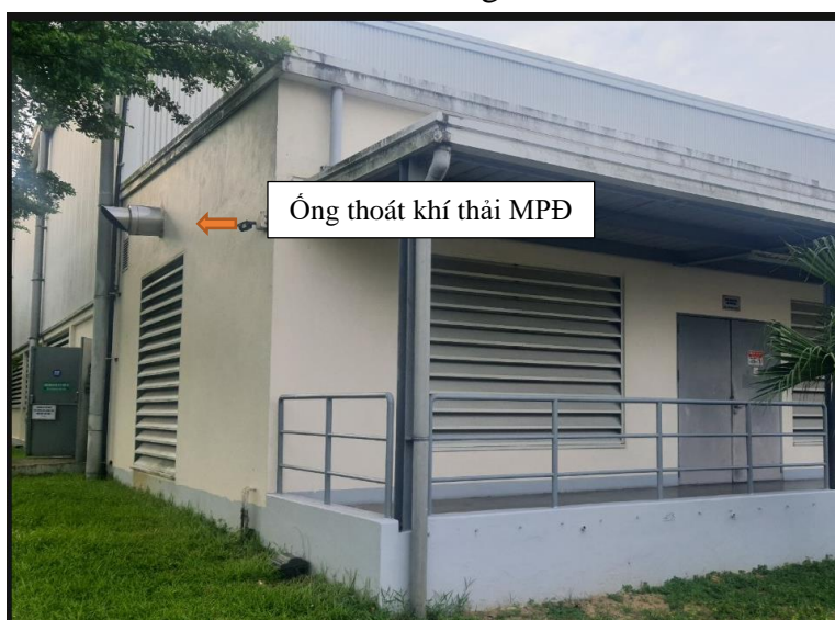
Hình 3.12. Ống thoát khí thải máy phát điện
