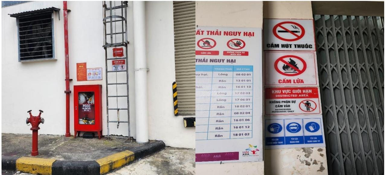
Hình 3.17. Hệ thống PCCC tại Cơ sở
