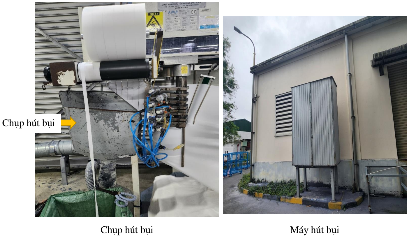
Hình 3.7. Hệ thống xử lý bụi
