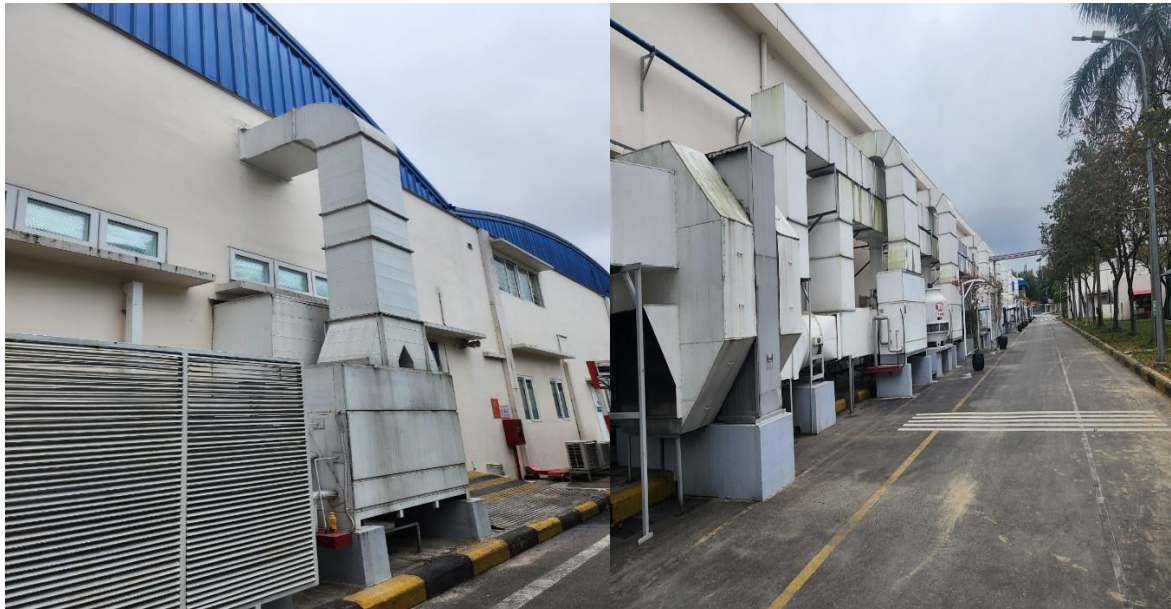
Hình 3.10. Hệ thống làm mát trong nhà máy
